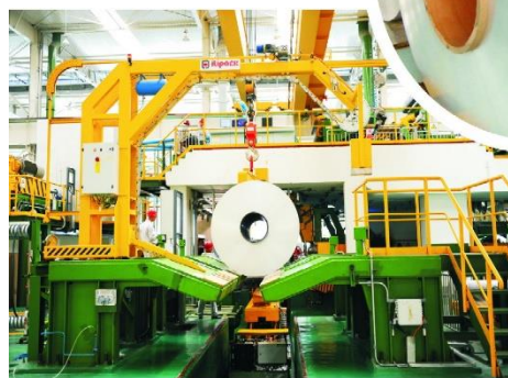
达涅利切边机 Danieli Edge Trimming Line
